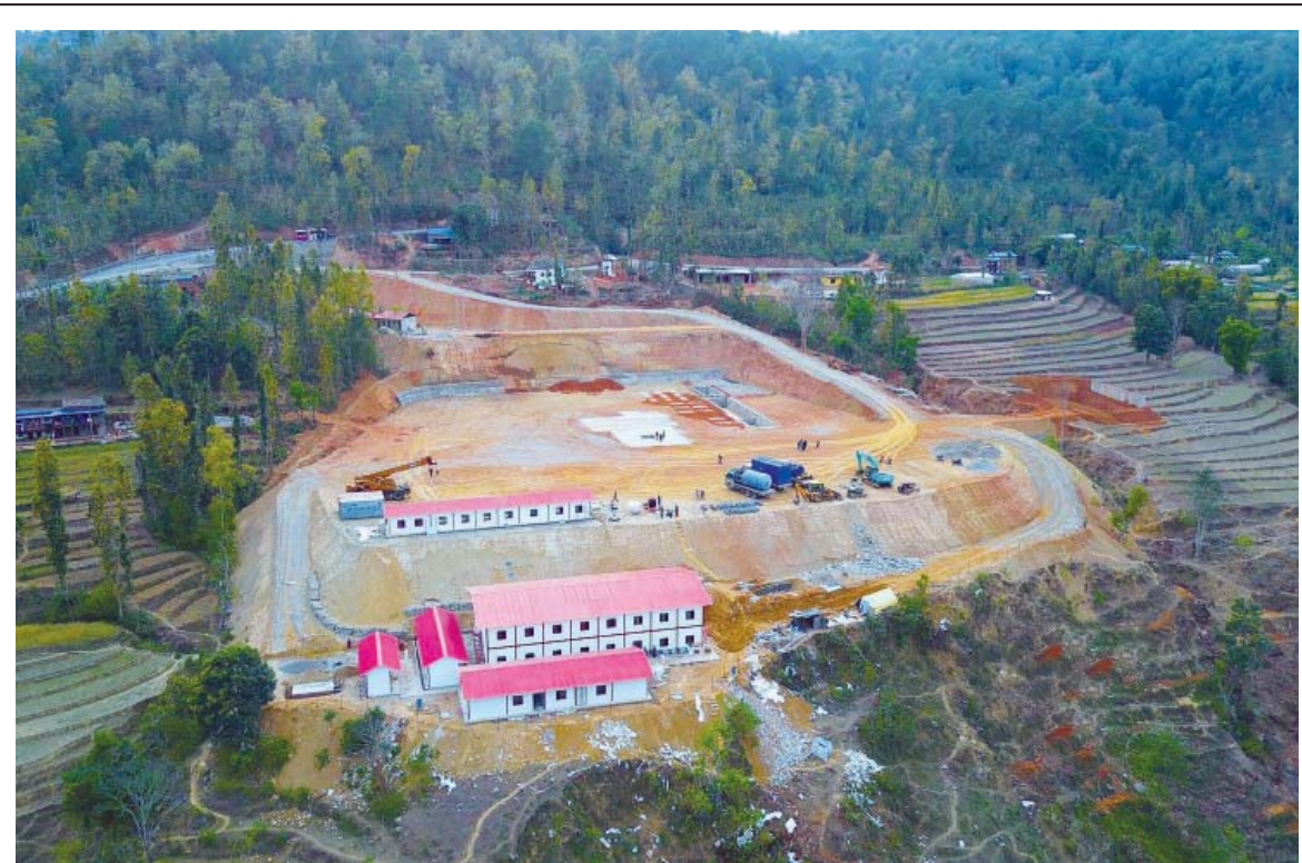
पेट्रोलियम पदार्थ अन्वेषणस्थल | दैलेखको भैरवी गाउँपालिका-१ जलजलेमा रहेको पेट्रोलियम पदार्थ अन्वेषणस्थल। ड्रिलिङ सर्वेको कामका लागि ठूला उपकरणहरू आउन थालेपछि यहाँ पेट्रोलियम पदार्थको उत्खनन गर्ने काम धमाधम भइरहेको छ। तस्विर: सुरेश आचार्य/रासस
