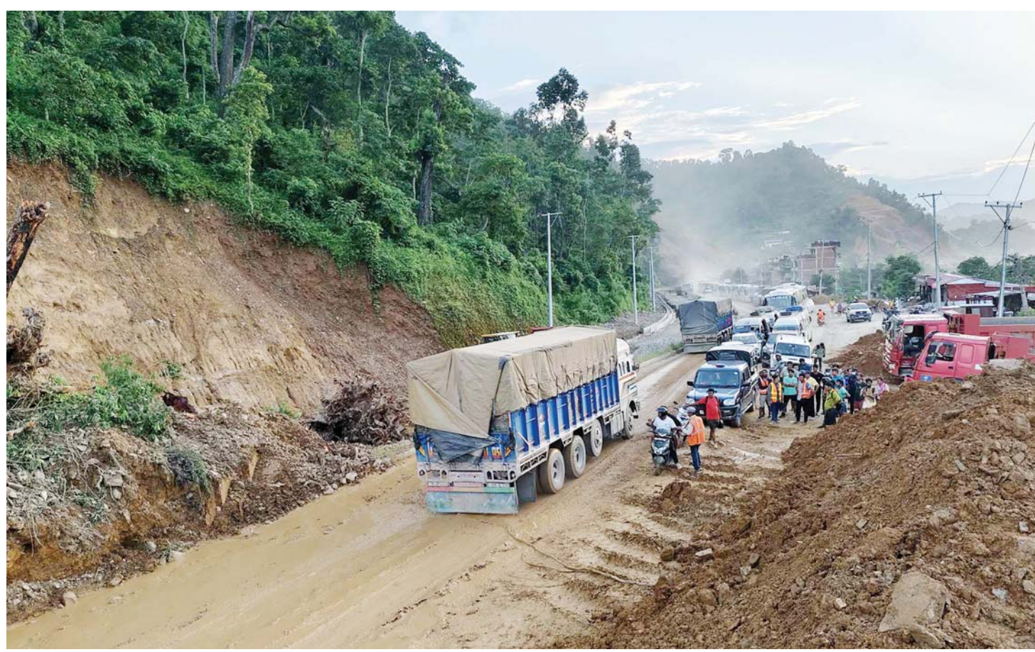
पहिरो पन्छापछि पृथ्वीराजमार्गअन्तर्गत तनहुँको व्यास नगरपालिका-१२ घाँसीकुवामा खसेको पहिरो पन्छापछि एकतर्फी सञ्चालनमा आएको सडक। सडकको पहिरो एकतर्फी सडक हटाएपछि एकतर्फी सञ्चालनमा आएको हो। तस्वीर: कृष्ण त्योंपाने/रासस
