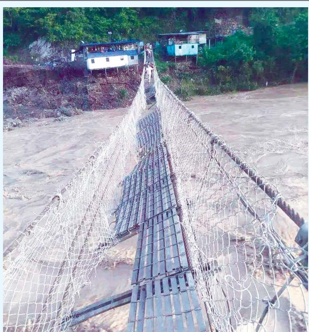
कोलुंगेपुलमा क्षति अविरल वर्षाका कारण आएको बाढीले भोजपुरको दक्षिण हनुवागढी गाउँपालिका-९ चुहार र उदयपुरको बेलका नगरपालिका-८ मैनामैनी जोडने धुकासी नदीमाथिको कोलुंगे पुलमा पुन्याएको क्षति। पुलको बीच भागमा रहेको ३० वटा प्लेट बगाएपछि आवतजावतमा समस्या भएको छ। तस्विर: निरोज कोइराला/रासस
