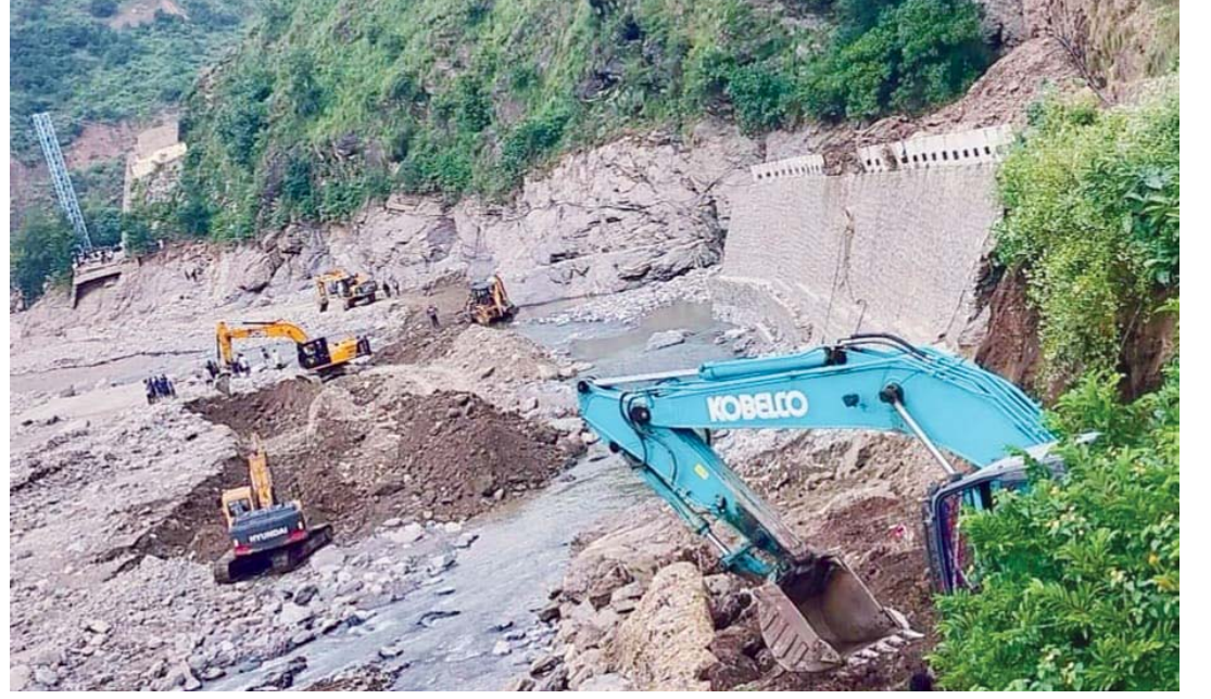
बाढीले क्षतिग्रस्त बिपी राजमार्गमा ट्याका खुलाउने काम हुँदै ।
