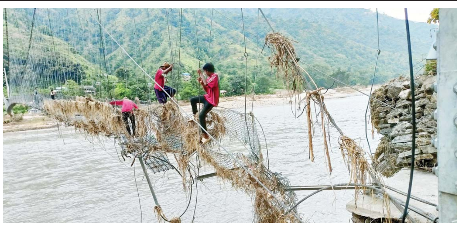
जोखिमपूर्ण सिन्धुलीको गोलजोर गाउँपालिका-६ बलेनी र आनामानेबीचमा रहेको रामेछाप गाउँपालिका-९ मा जोडिएको क्षतिग्रस्त भोलुंगे पुलमा जोखिम मोलेर यात्रा गर्दै रामेछापवासी । असोज १२ गते सुनकोसी नदीमा आएको बाढीले पुलमा क्षति गरेको हो । तस्विर: राधिका बुढाथोकी/रासस
